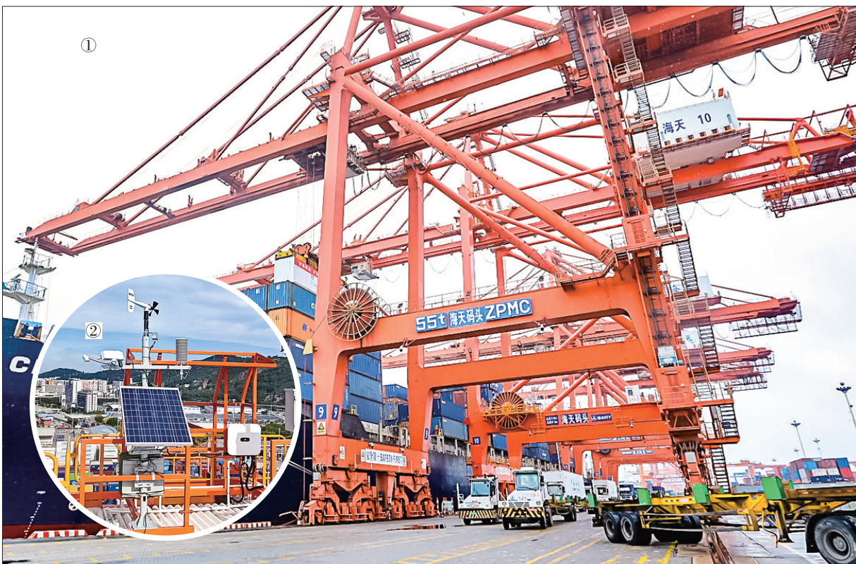
7月30日,厦门港首个码头桥吊自动气象站在海天码头成功建成,并正式投入使用。该站点安装于海天码头10号桥吊机房顶部,高度融入码头一线生产环境,其风力、风速、能见度等的观测数据更具参考价值。
